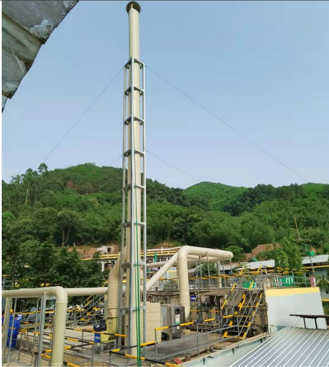
污水处理站臭气治理设施
